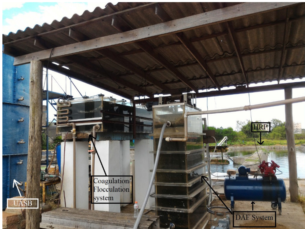
Fig. 1 – Sistema piloto de tratamento de efluentes.
